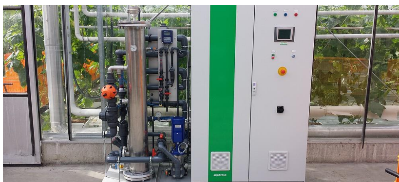
Ozoninstallatie voor waterbehandeling in de tuinbouw ( www.glastuinbouwwaterproof.nl )
