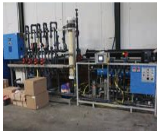
Installatie voor omgekeerde osmose ( https://www.glastuinbouwwaterproof.nl )
